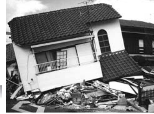
1階だけが潰れ、2階が落ちてくるような倒壊が目立った。
